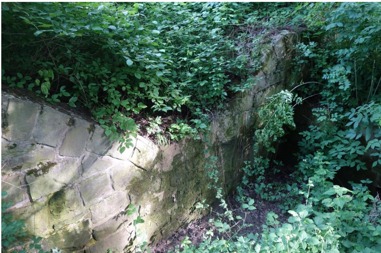
Abbildung 24: Verbauter unterer Abschnitt des Hollergrabens mit hohen Abstürzen (Foto: BPWW/J. Scheibhofer)
