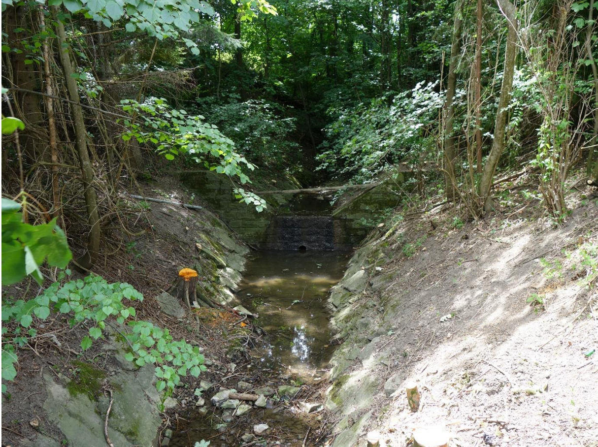
Abbildung 74: Absturz nach einer Grundschwelle am Laaber Bach bei der Karl Schindler-Gasse (Foto: BPWW/J. Scheibhofer)
