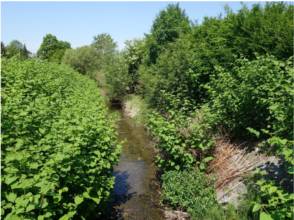
Abbildung 42: Anzbach bei Karl Lechner Brücke. Die Uferbefestigung ist durch den Staudenknöterich-Bestand kaum erkennbar (Foto: BPWW/J. Scheiblhofer)
