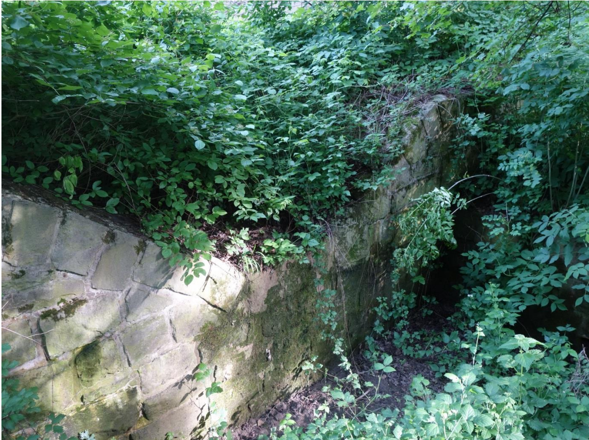
Abbildung 42: Verbauter unterer Abschnitt des Hollergrabens mit hohen Abstürzen (Foto: J. Scheibhofer)
