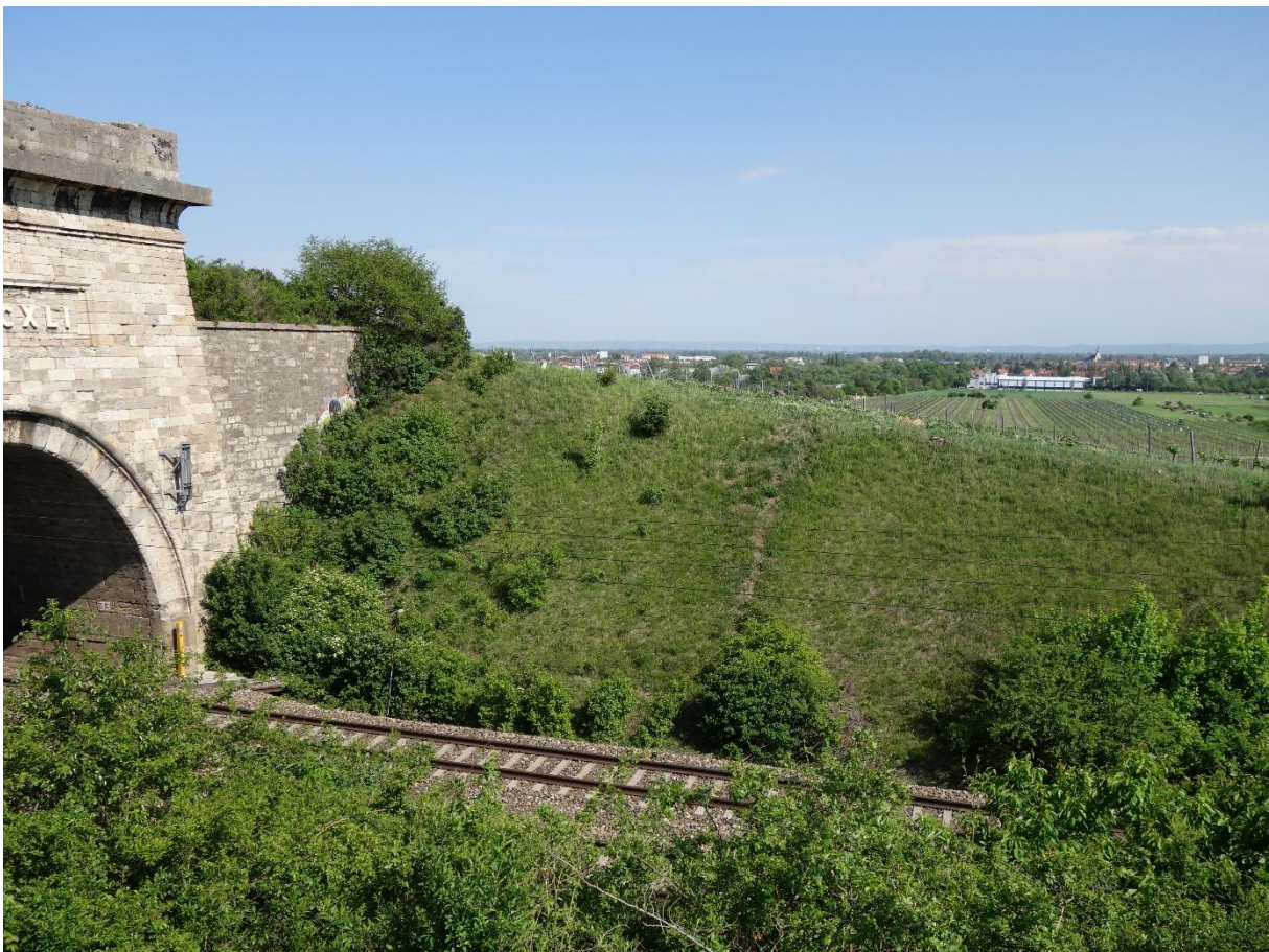
Abbildung 17: Besonders beim Südportal des Busserltunnels breiten sich vermehrt Gehölze aus (Foto: BPWW/J. Scheibhofer)
